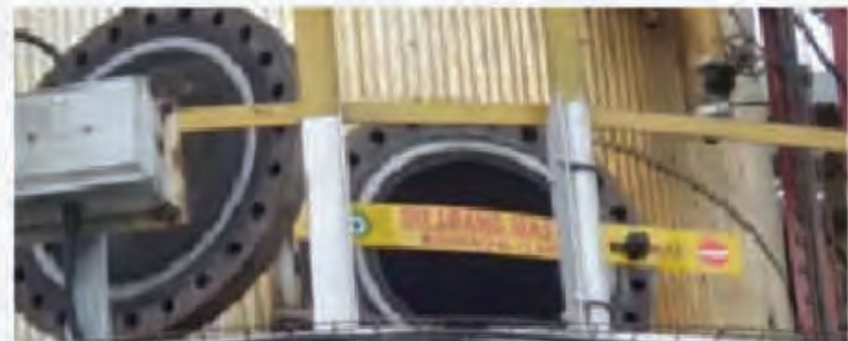
Ruang terbatas pada vessel diberi safety sign .
