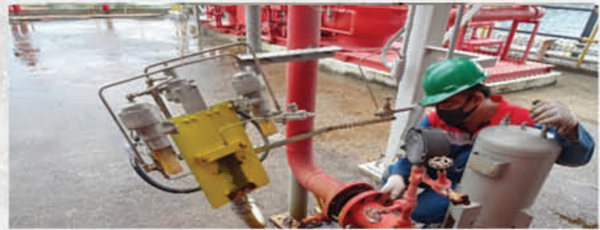
Pekerja maintenance sedang melepas blind pada fire water line menggunakan peralatan yang layak pakai.
