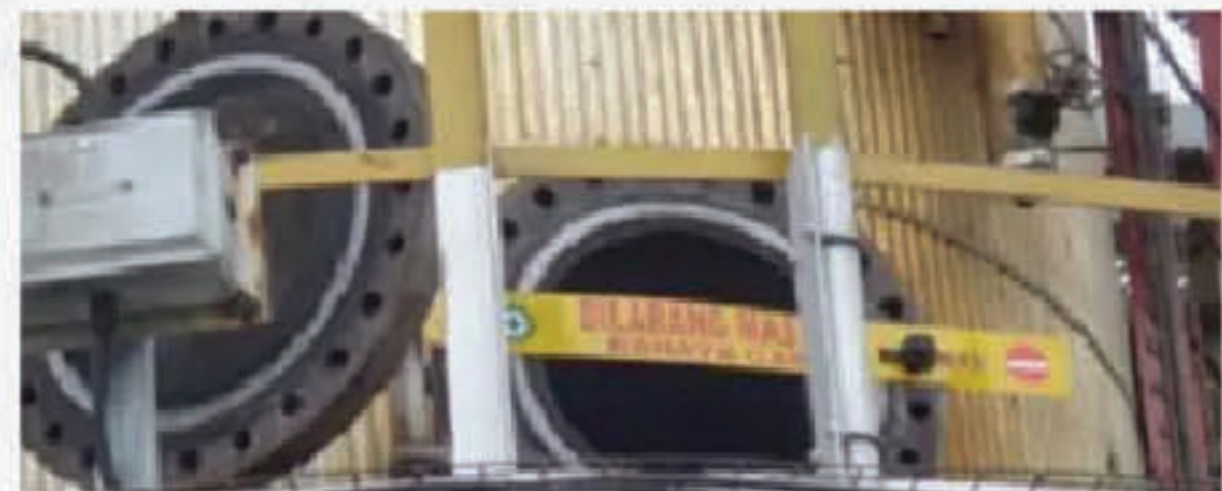
Ruang terbatas pada vessel diberi safety sign .
